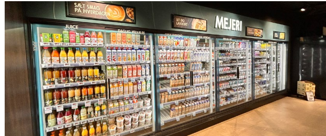
MENY Græsted er en af de butikker, der har fået udskiftet køle- og frostanlæg med støtte fra KFI.
